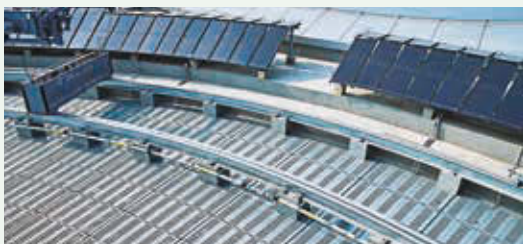
中信大廈光伏發電系統
