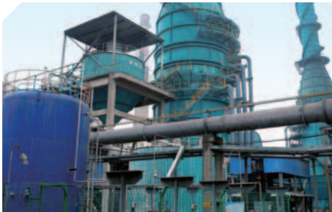
興澄特鋼電廠脫硫設備
