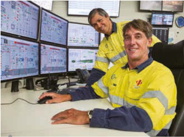
— 中信澳礦發電站控制室
